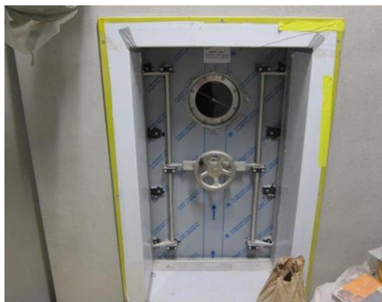
Neu eingebaute Drucktüre
