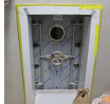
Neu eingebaute Drucktüre
