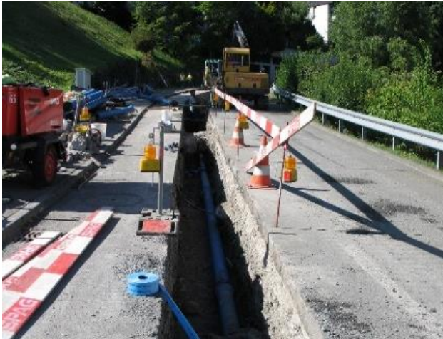
Transportleitung der Wasserversorgung
