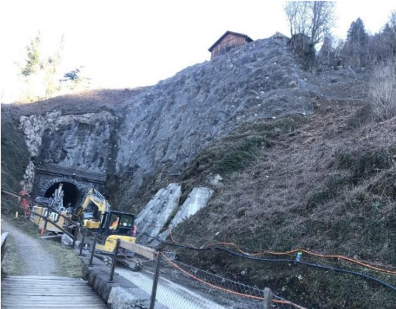
Vernagelte Netzabdeckung oberhalb Tunnelportal
